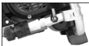
Doprowadzenie wody zamknięte (dźwignia zaworu ułożona prostopadłe)
